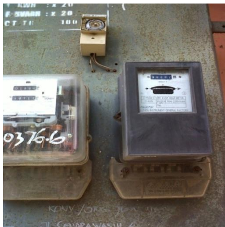
Gambar 4. Meter ganda ada pelanggan I-2
