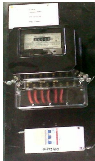
Gambar 3. Meter KWh yang terpasang pada pelanggan I-2 dengan daya 16.500 VA 3 fasa.
