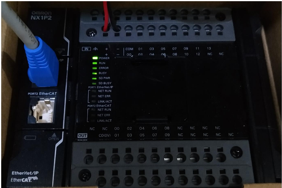
PLC baru dihidupkan dan kabel ethernet baru dihubungkan
