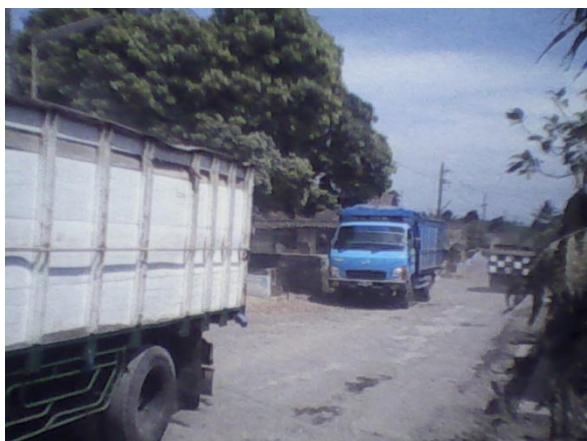
Gambar 2. Tingginya Lalu Lintas Kendaraan Membuat Mudah Rusaknya Jalan
