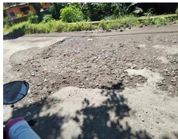
Gambar 5. Kondisi Jalan di Desa Luragung Landeuh
