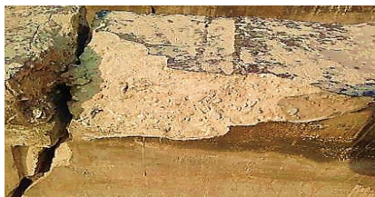
Gambar 10. Patahan beton saluran pembuangan air limbah (sudah tidak berfungsi) di Pantai Jati yang terbuat dari campuran pasir laut. (Dok. Peneliti)
