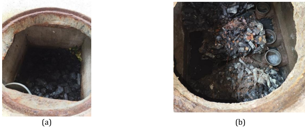
Gambar 10. Kondisi Bak Anaerobik Biofilter Media Arang pada (a) IPAL Balumbang Kulon dan (b) IPAL Balumbang Wetan Sumber: Hasil Dokumentasi, 2024
