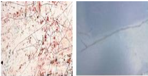
Gambar 8. Bentuk kerusakan/keretakan pelat zona lambung
