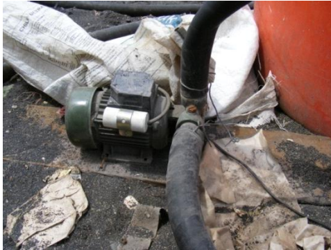
Gambar 4.13. Pompa Sirkulasi Air
