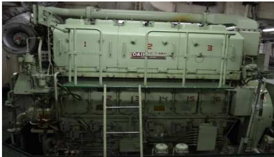
Gambar 2. Mesin bantu kapal ( Generator ) Mesin bantu kapal ( generator set ) sama seluruh permesinan harus beroperasi dalam kisaran parameter tertentu. Instruments akan mengukur parameter pada voltase, ampere meter, daya listrik, tekanan, suhu, tekanan minyak pelumas, temperatur gas buang, konsumsi bahan bakar, dan komponen lain. [4]
