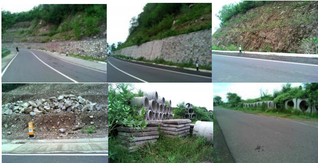
Gambar 17. Drainase jalan untuk mengalirkan air limpasan
