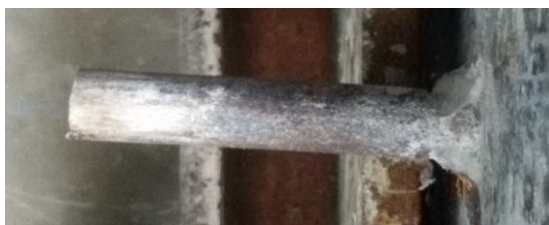
Gambar 5. Terjadi kebengkokan pada shear connector diameter 16 mm dengan panjang 80 mm
