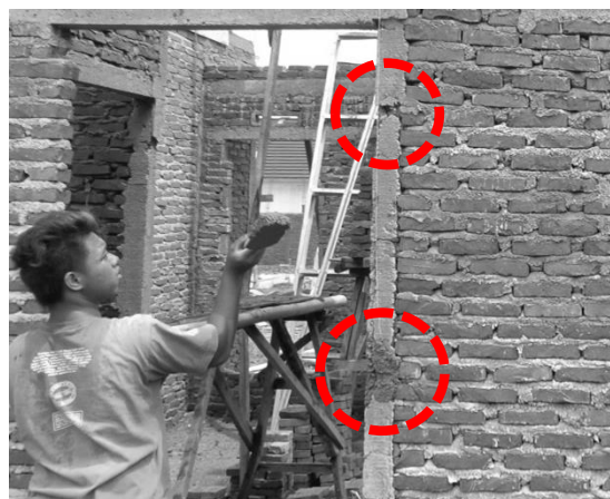
Gambar 16. Tulangan kolom yang terlihat ditutupi dengan adukan mortar ( grouting )
