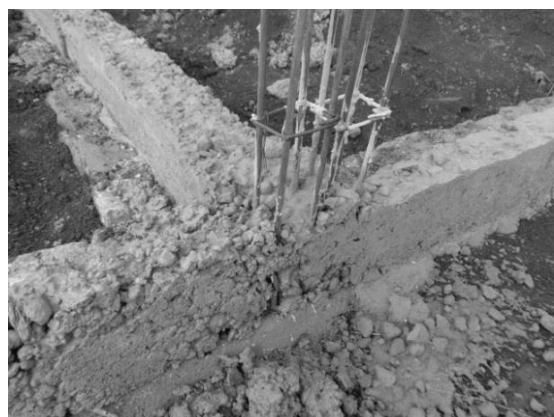
Gambar 15. Beton tidak padat serta banyak rongga udara pada balok pondasi
