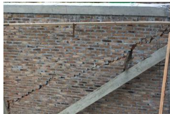
Gambar 12. Pola retak pada benda uji setelah pengujian
