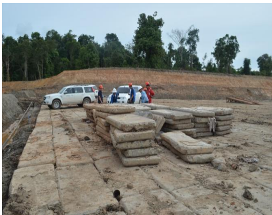
Gambar 1. Slab beton dengan kerusakan spalling
