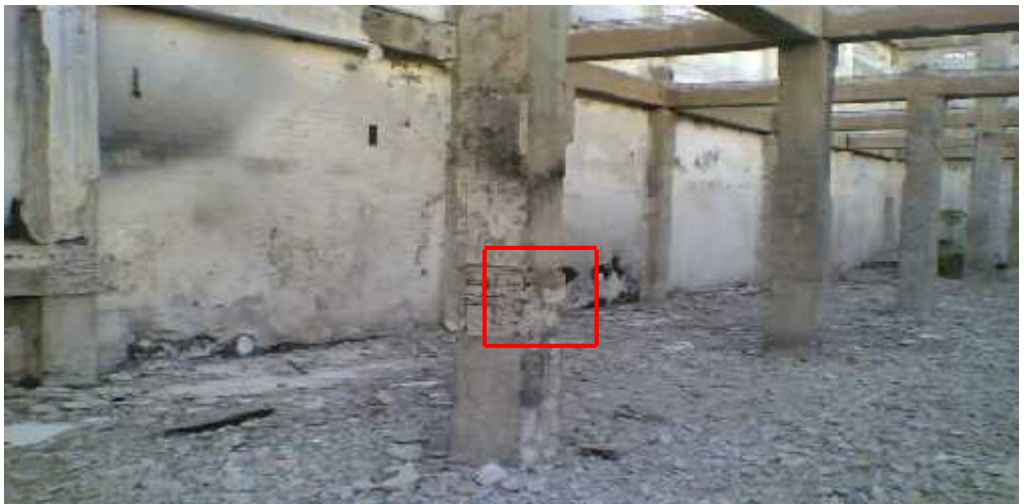
Gambar 7. Tulangan yang ter- exposed pada kolom
