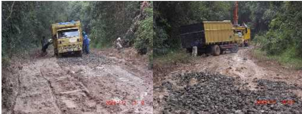
Gambar 2. Keruntuhan geser lokal ( local shear failure ) pada sub grade menyebabkan batuan base course amblas (tenggelam).
