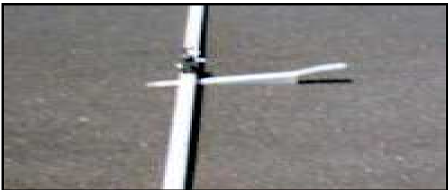
Gambar 7. Kasus deformasi plastis di Jalan Tol Cirebon-Palimanan (April 2004)
