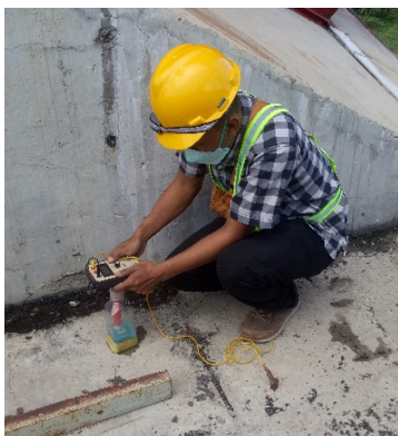
Gambar 7. Uji korosi beton pada abutment jembatan dekat posisi angkur
