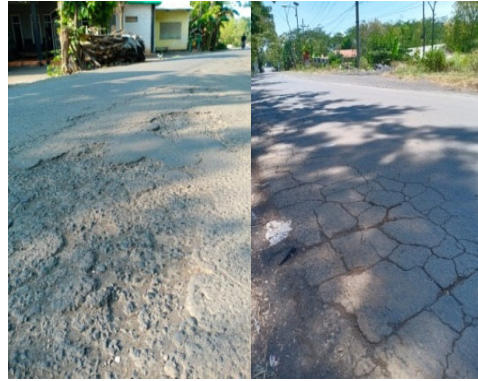
Gambar 2. Kerusakan retak buaya dan disintegration
