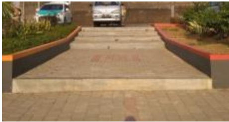
Gambar 4. Kondisi Tangga (Christy, 2018)
