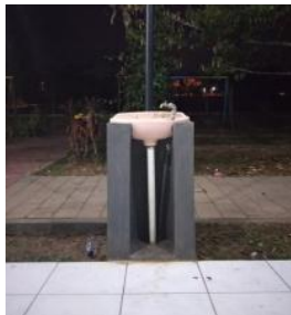
Gambar 7. Kondisi Wastafel (Christy, 2018)
