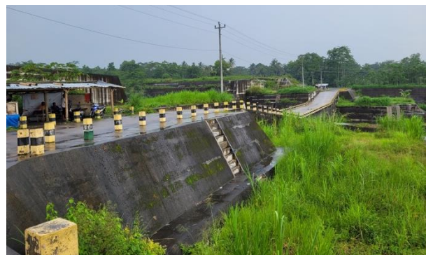
Gambar 6 Seting fisik dan kesan ruang jika berada di atas bangunan sabo dam Kali Gendol.
