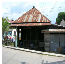
Rumah tipe balai bini dengan kondisi kurang baik
