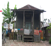
Rumah tipe balai bini dengan kondisi kurang baik
