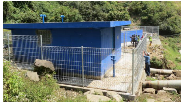
Gambar 2 BPT 2 Jalur Tranmisi Bergas II yang beropetensi menghasilkan listrik 253 kw.
