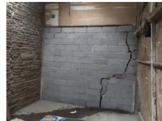
Retakan dalam rumah penduduk yang ditimbun tanah
