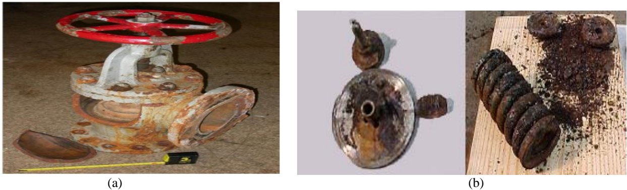
Gambar 2. (a) Keptahan pada pressure relief valve [2], dan (b) Kebocoran pada pressure relief valve [2]
