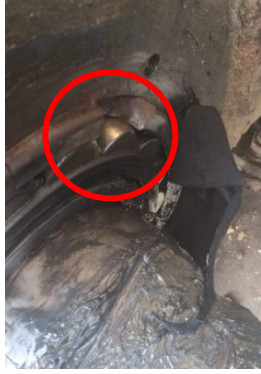
Gambar 6. Retak dan pecah yang terjadi pada bantalan
