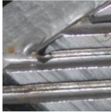
Gambar 9. Detail B kerusakan bengkok pada disc refiner Airaghi
