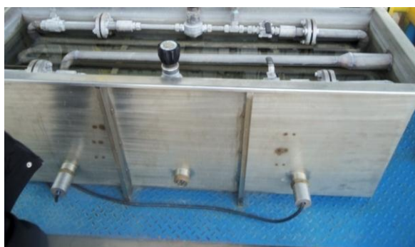
Gambar 3. Heat Exchanger yang terpasang
