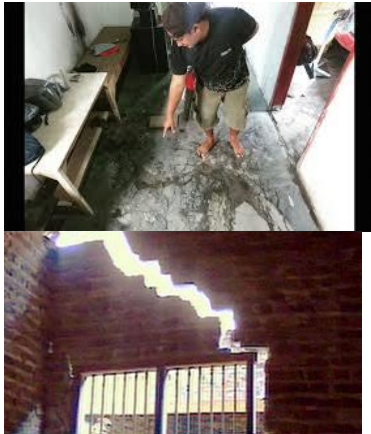
Gambar 5: Kondisi retak-retak pada dinding dan lantai rumah warga di Desa Renokenongo dan Tanggulangin (Sumber : https://www.google.co.id/search?q=gambar+rumah+retak+lapindo&afe )
