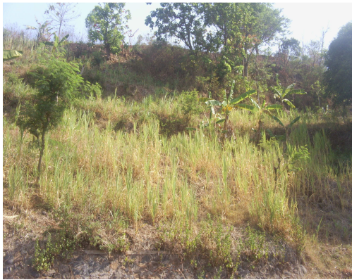
Gambar 5. Tipe gerakan tanah berjenis slide , terdapat retakan panjang yang arahnya relatif barat – timur rock fall
