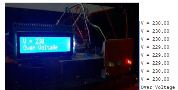
Gambar 12. Kondisi Over Voltage
