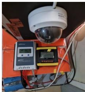
Gambar 15. Instalasi Wiring Terpasang
