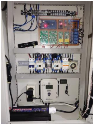
Gambar 8. Realisasi Panel Box Sistem Smart Control Suplai Beban tampak dalam
