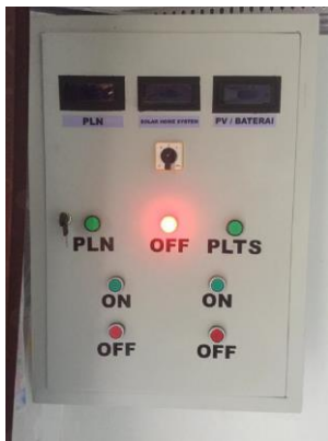
Gambar 7. Realisasi Panel Box Sistem Smart Control Suplai Beban tampak depan
