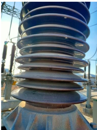
Gambar 4. Kondisi isolator terpasang
