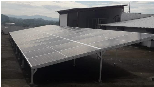
Gambar 1. Instalasi Panel Surya di Gedung Teknik
