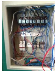
Gambar 3. Sistem relay untuk electricity management pada ruang B.301
