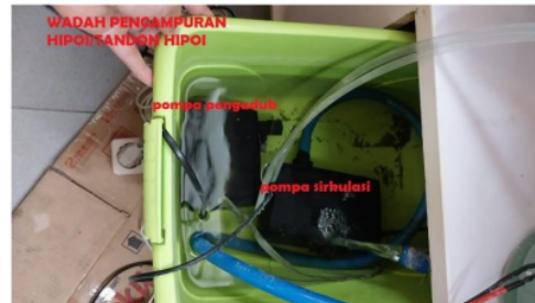
Gambar 10. Pompa pengaduk dan pompa sirkulasi
