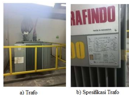
Gambar 2. Foto dan Data Spesifikasi Trafo
